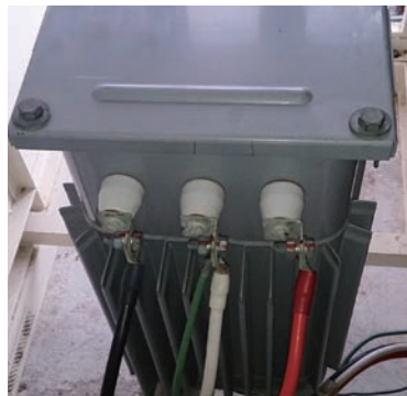
■トランス(変圧器)
